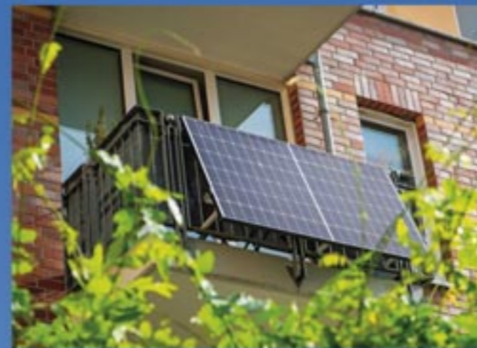
Abbildung 2: Beispiel einer Balkon-PV-Anlage ( https://energys.de/ratgeber/photovoltaik/balkonkraftwerke/ )
